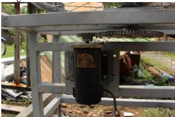
Gambar 5. Generator yang sudah terpasang
