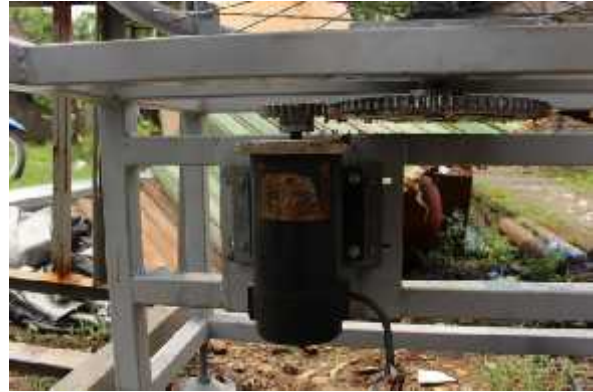
Gambar 5. Generator yang sudah terpasang
